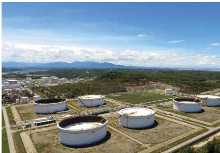
Khu bể chứa dầu thô của Nhà máy Lọc dầu Dung Quất. Ảnh: BSR
